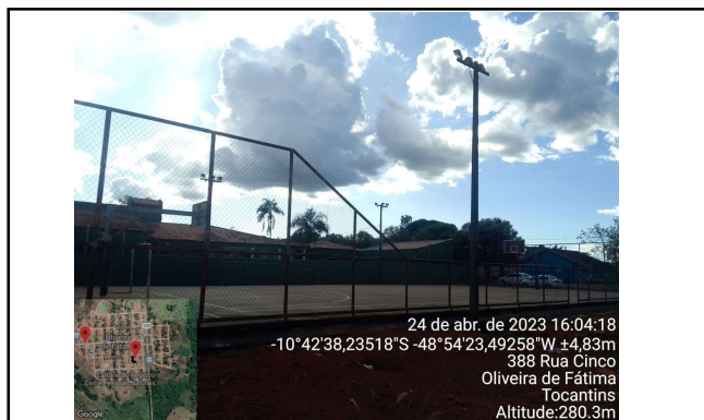
FOTO 06 - ALAMBRADO DA QUADRA DE ESPORTE
