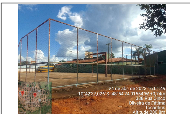
FOTO 01 - ALAMBRADO DA QUADRA DE ESPORTE
