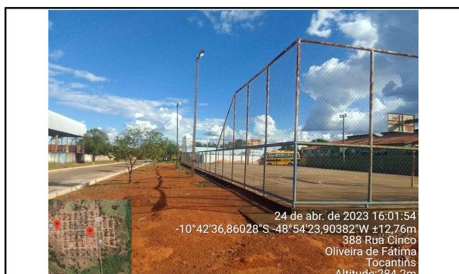
FOTO 04 - ALAMBRADO DA QUADRA DE ESPORTE
