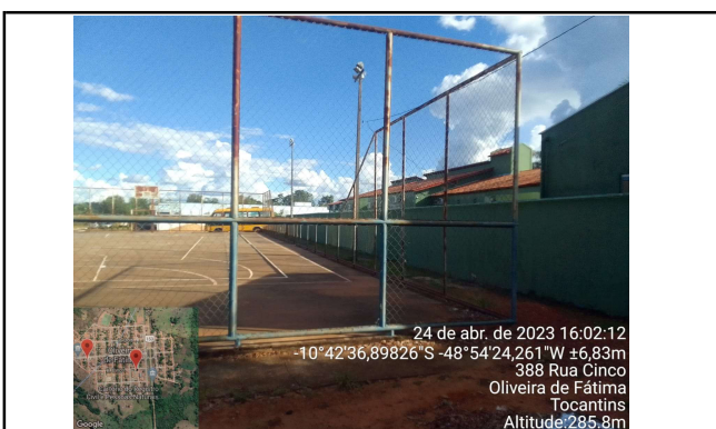
FOTO 03 - ALAMBRADO DA QUADRA DE ESPORTE
